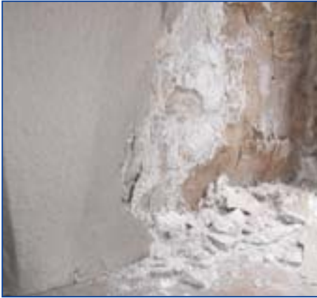
1 Nasses, salzbelastetes und durchfeuchtetes Mauerwerk.
