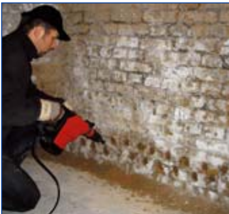
4 Anlegen der Bohrlöcher in einem Abstand von 10-12,5 cm. Der Bohrlochdurchmesser richtet sich nach dem angewendeten Verfahren.
