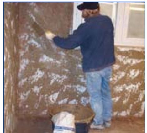
6 Im Feuchtigkeitsbereich (oder ganzflächig) INTRASIT® Dichtschlämme/-DS 1 und INTRASIT® Verkieselung im Wechsel zweimalig aufbringen. Anschließend einen Haftspritzbewurf aus INTRASIT® Vorspritz WTA netzartig deckend auftragen.
